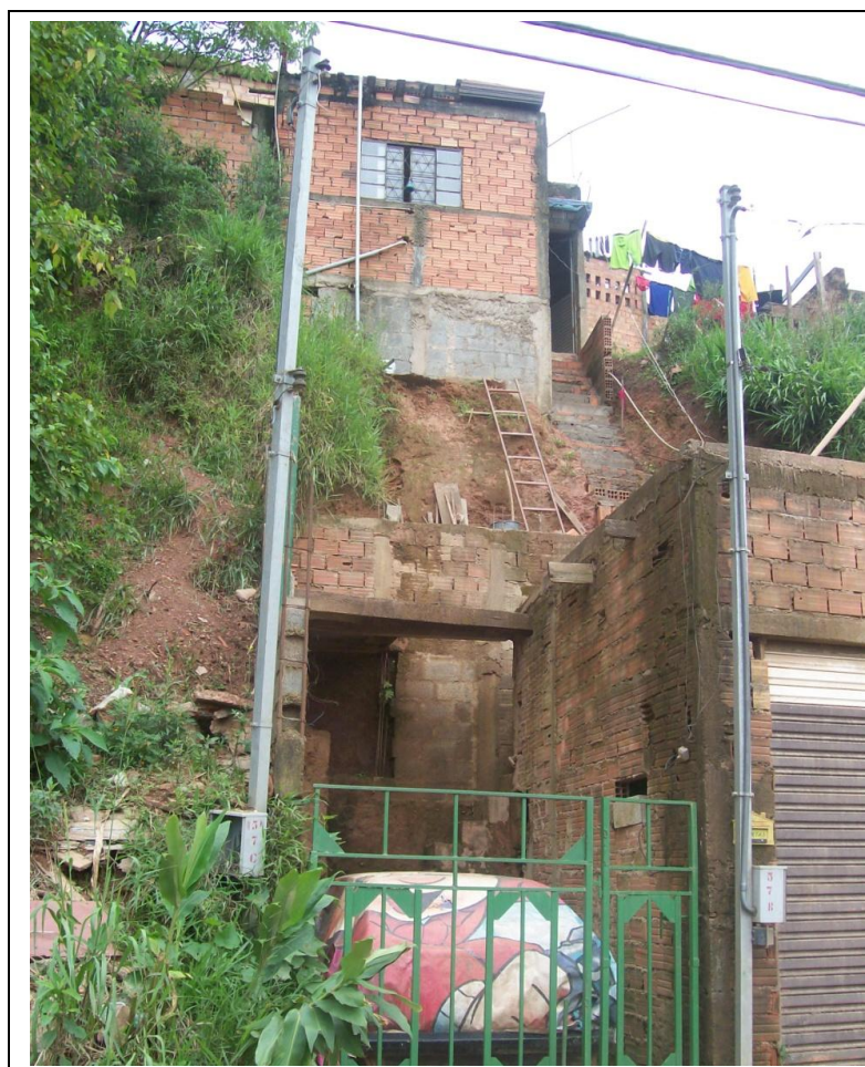
FIGURA 9. Habitação em terrenos íngremes, sujeitos a riscos de escorregamentos. (Foto da autora. 11/2009).
