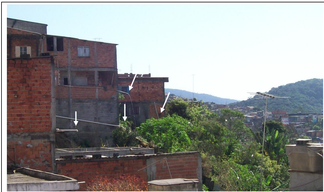
FIGURA 8. Encanamentos residenciais expostos com liberação de água na encosta. (Foto da autora. 11/2009).
