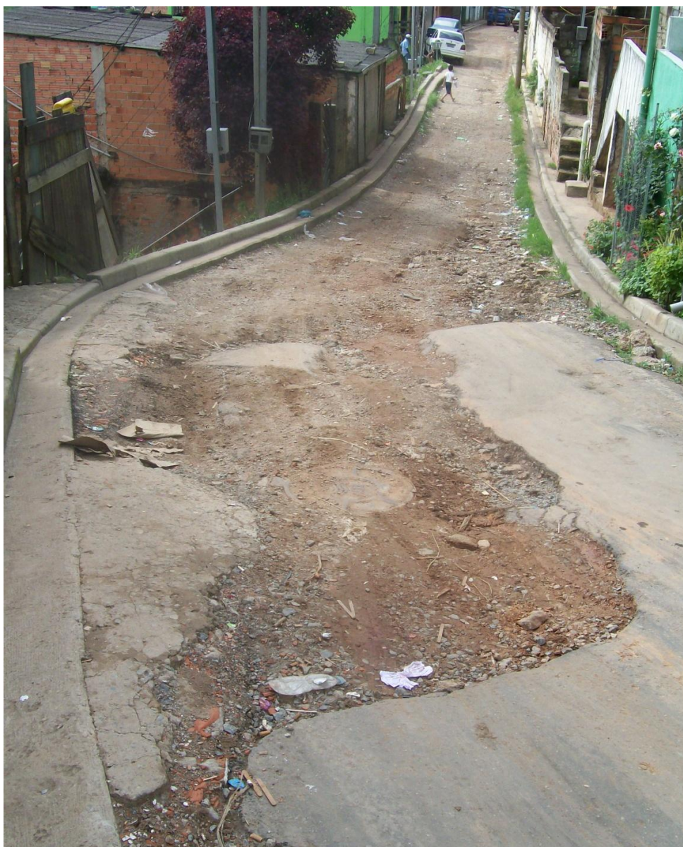
FIGURA 5. Erosões geradas pelo fluxo e velocidade das águas. (Foto da autora. 11/2009).
