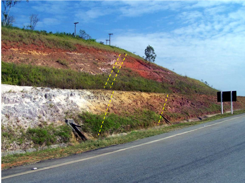
FIGURA 7.8 – Foto da vista geral do corte na Rodovia Carvalho Pinto, trevo de acesso a Guararema (Ponto 3). As linhas tracejadas demarcam zona de falha, com maior umidade e tingimento ocre dos sedimentos afetados. A direção da zona de falha é ENE-WSW (a foto foi tirada no rumo SW; o bloco baixo é o da direita).
