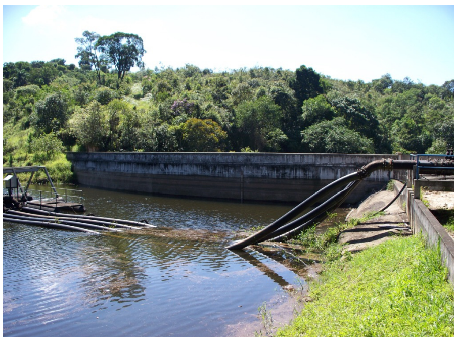
Figura 17: Bombas de captação de água do Reservatório Cabuçu. Fonte: Laboratório de Geoprocessamento / UnG.
