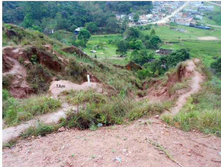
Figura 71 - Ravinamento intenso em talude de TAm encontrado em área localizada na rua Onildes Zanzini Pereira em trecho final do loteamento (foto de Vitorino, 2013).
