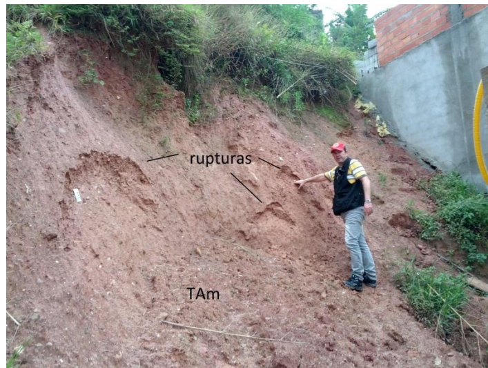
Figura 67 - TAm encontrado em talude de escavação no fundo do lote situado nº 562 na av. Nair de Oliveira Costa. Notar a ocorrência de pequenas rupturas que demonstram suscetibilidade a movimento de massa destes depósitos (foto de Andrade, 2013).
