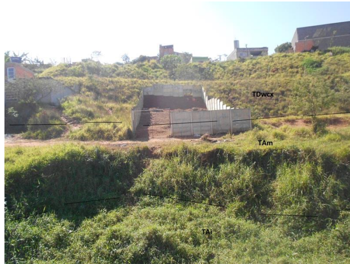
Figura 88 - TDcx em taludes escalonados onde estão situados lotes de uma quadra localizada entre a av. João Colado e a rua Roberto Magalhães (foto de Vitorino, 2013).
