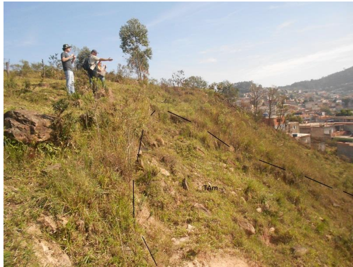
Figura 73 - Topo de talude de TAM. Tracejado aponta a cabeceira do escorregamento circular encontrado em área localizada ao final da rua Manoel Benevides de Almeida em trecho limítrofe do loteamento (foto de Vitorino, 2013).
