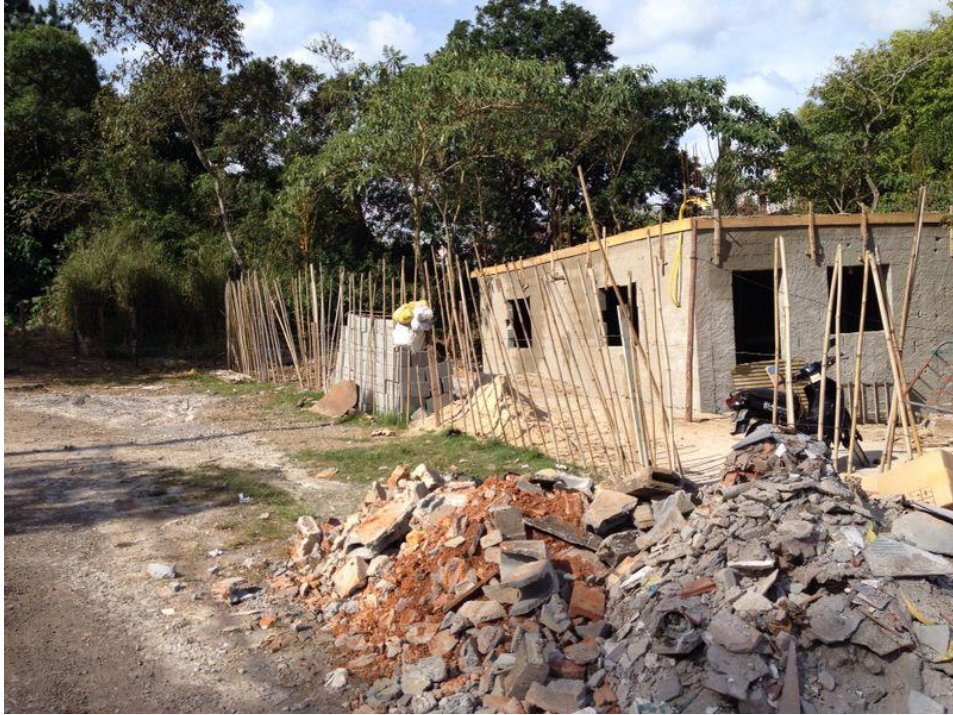
Figura 13: Edificação sobre o sistema de canalização da nascente do Baquirivu-Guaçu (Foto do autor).
