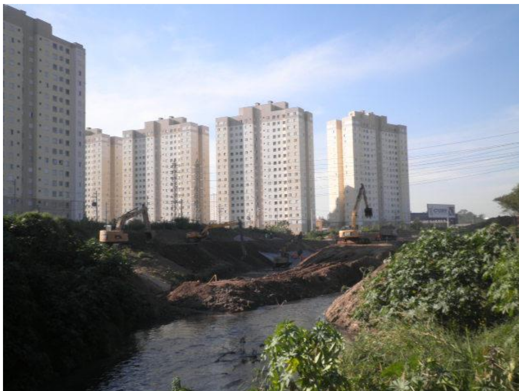
Figura 10.2 – Obras de Construção de CC-01 – bairro Ponte Grande Foto: setembro de 2013 (acervo próprio).
