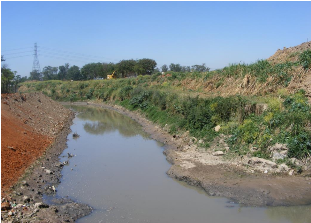
Figura 8.4 – Depósitos tecnogênicos no Canal de Circunvalação entre os bairros Porto da Igreja e Ponte Grande - Foto de 04/05/2013 (acervo próprio).
